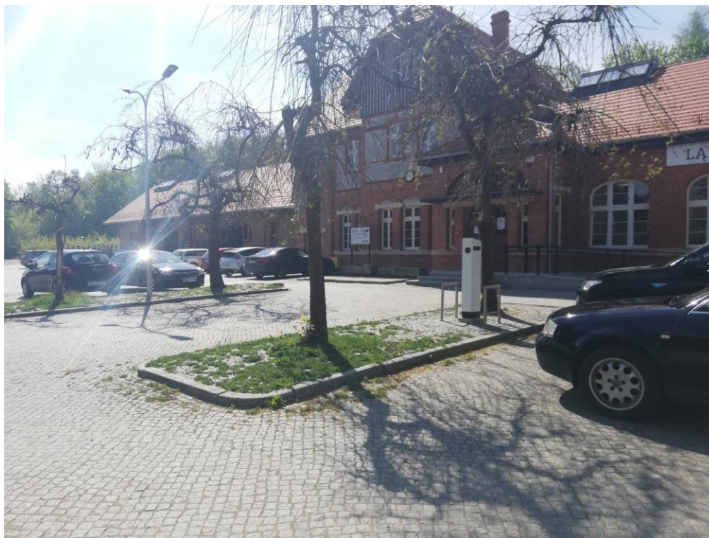
Rysunek 1. Stacja ładowania pojazdów elektrycznych w Łądku-Zdroju
